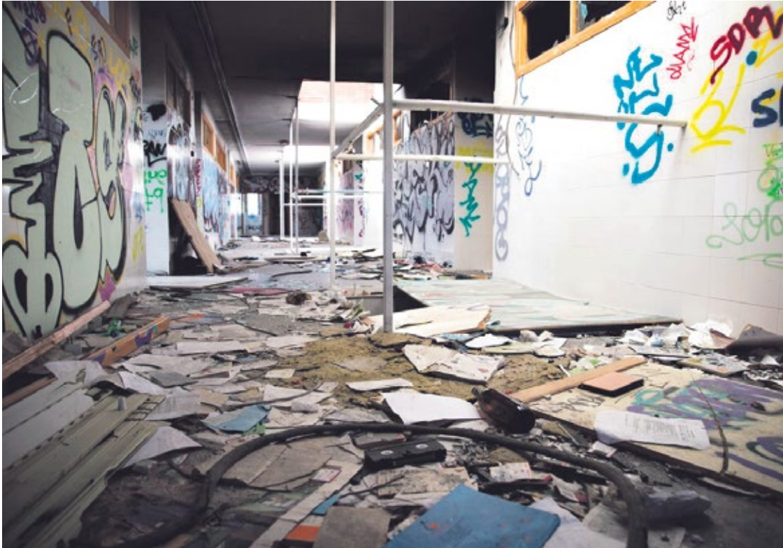
Tras años de abandono y actos vandálicos, este es el degradado aspecto en el interior del Rubén Darío. SANDRA BLANCO
