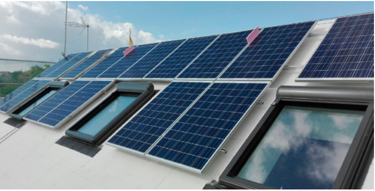
Paneles fotovoltaicos ubicados en la cubierta del edificio. ESTUDIO DMVD
