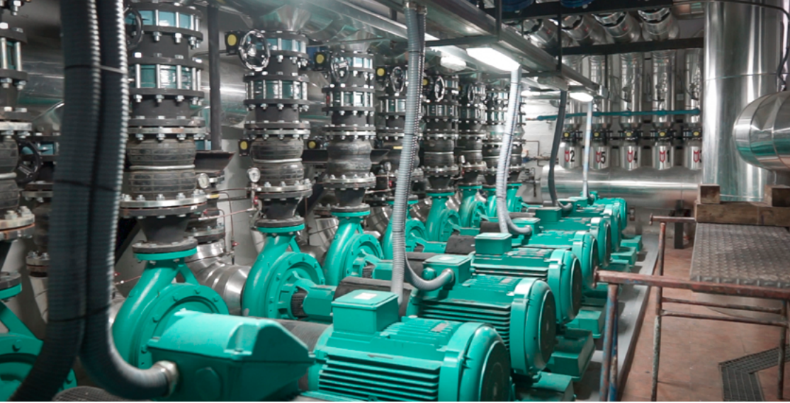
Interior de la sala de calderas de la Colonia de la Esperanza. DAVID NAVARRO
