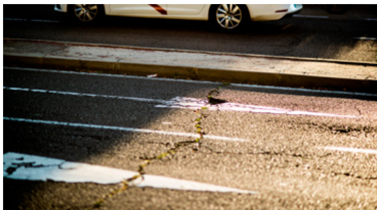
Grietas en el pavimento de la Carretera de la Estación de Hortaleza. SANDRA BLANCO
