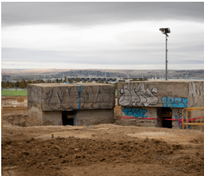
Estado en el que se encontraban los fortines el año pasado, antes de su restauración. DAVID NAVARRO
